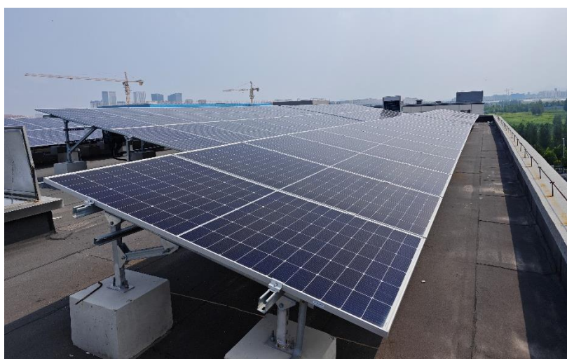
图 1 光伏发电装置
